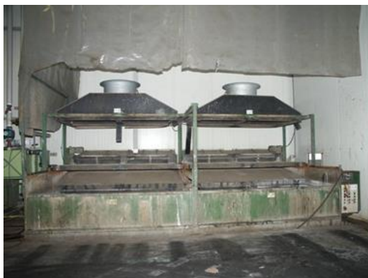
Ontsmetinstallatie met ventilatoren om de hoeveelheid aanhangende vloeistof snel te verminderen.
